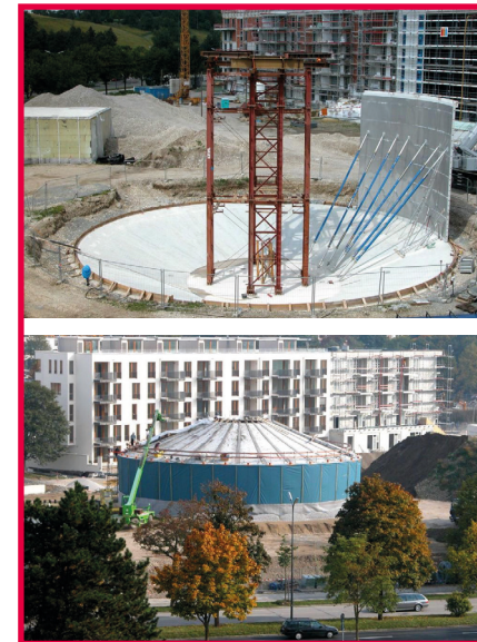
Solare Nahwärme Ackermannbogen München Volumen: 6.000 m³
