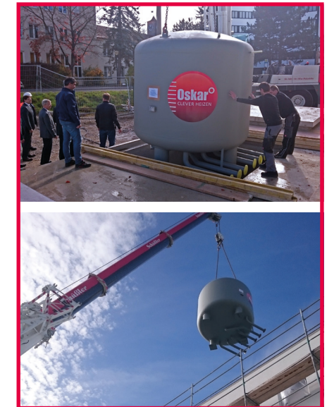
Nahwärmenetz Meitingen Volumen: 15 m³
